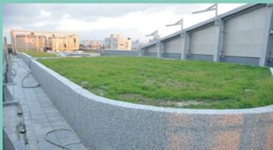
屋頂綠化 雙層屋頂/隔熱
